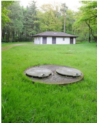
Sodaanlage und Brunnenfeld
